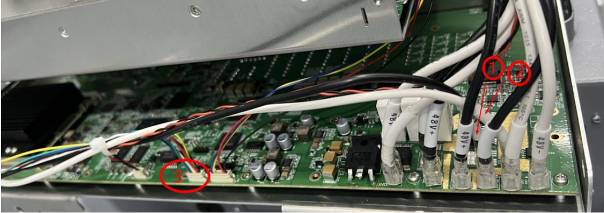
图 3-29 刹车板到 Safe IO 的线缆位置
