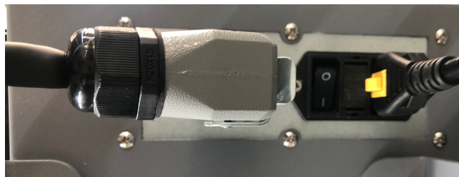
图 5-4：机器人线缆与控制箱的连接
